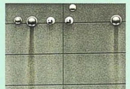
涙漏れによる外壁の変色
