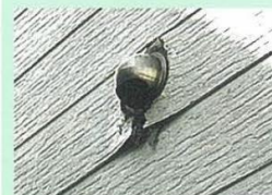
外壁 (サイディング) の凍壊
