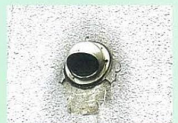
外壁 (モルタル) の凍壊
